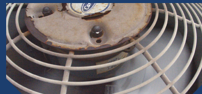
Unidades de Aire Acondicionado
